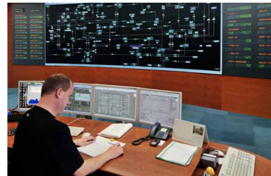
◀ V případě blackoutu by měl dispečink ČEPS plně ruce práce (foto ČEPS)
