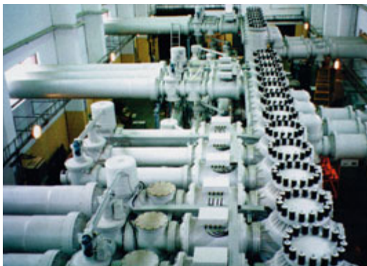
Zapouzdřená rozvodna Chodov
