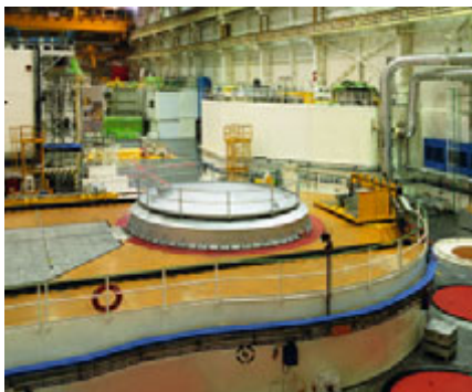
Reaktorový sál Jaderné elektrárny Dukovany
