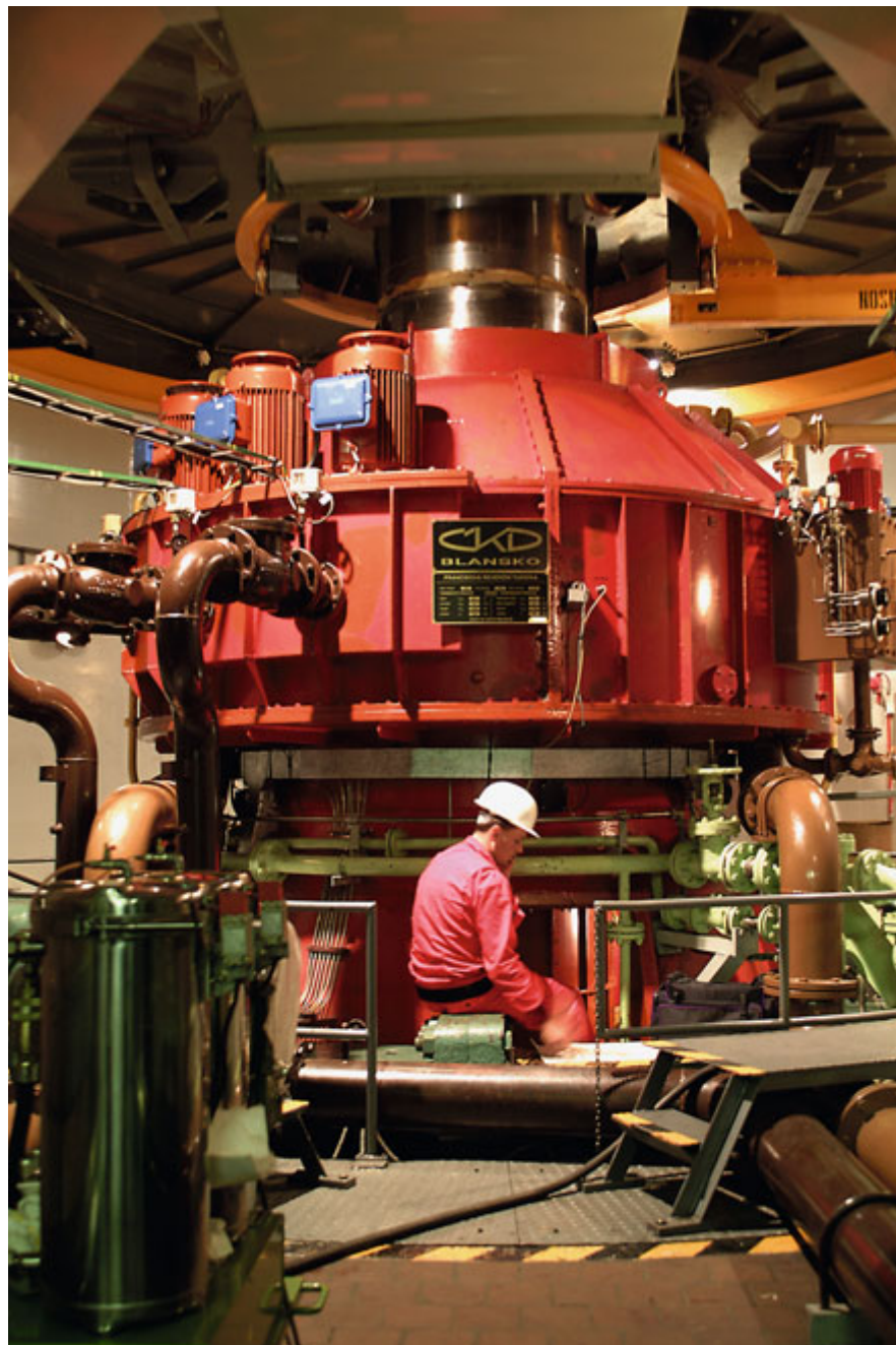
Vodní elektrárna Dlouhé Stráně, strojovna
