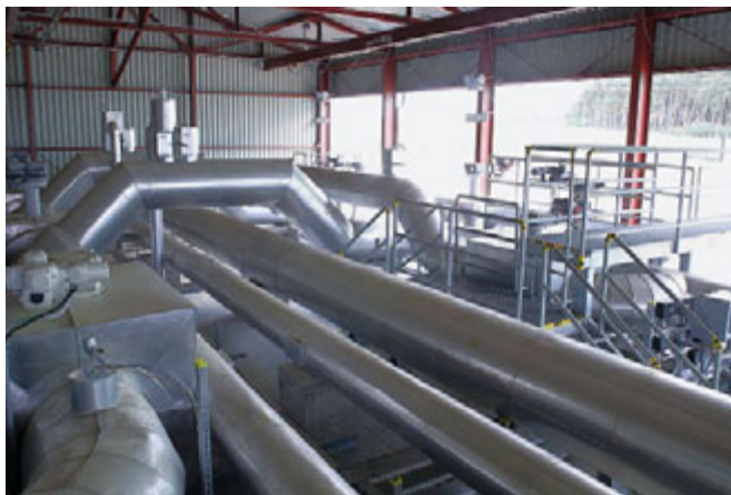
Přečerpávací stanice Benešovice
