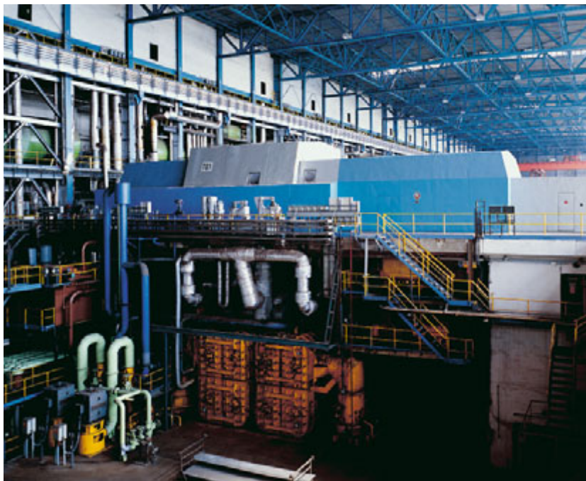
Strojovna Elektrárny Dětmarovice
