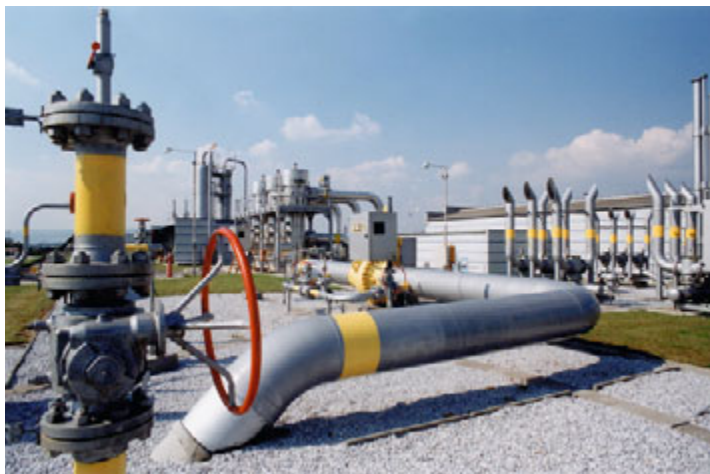
Rozvod plynu – Háje (Zdroj: RWE Transgas, a.s.)
