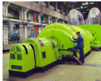
Strojovna Elektrárny Hodonín s turbínou 55 MW
