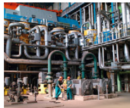
Zařízení strojovny Elektrárny Dětmarovice
