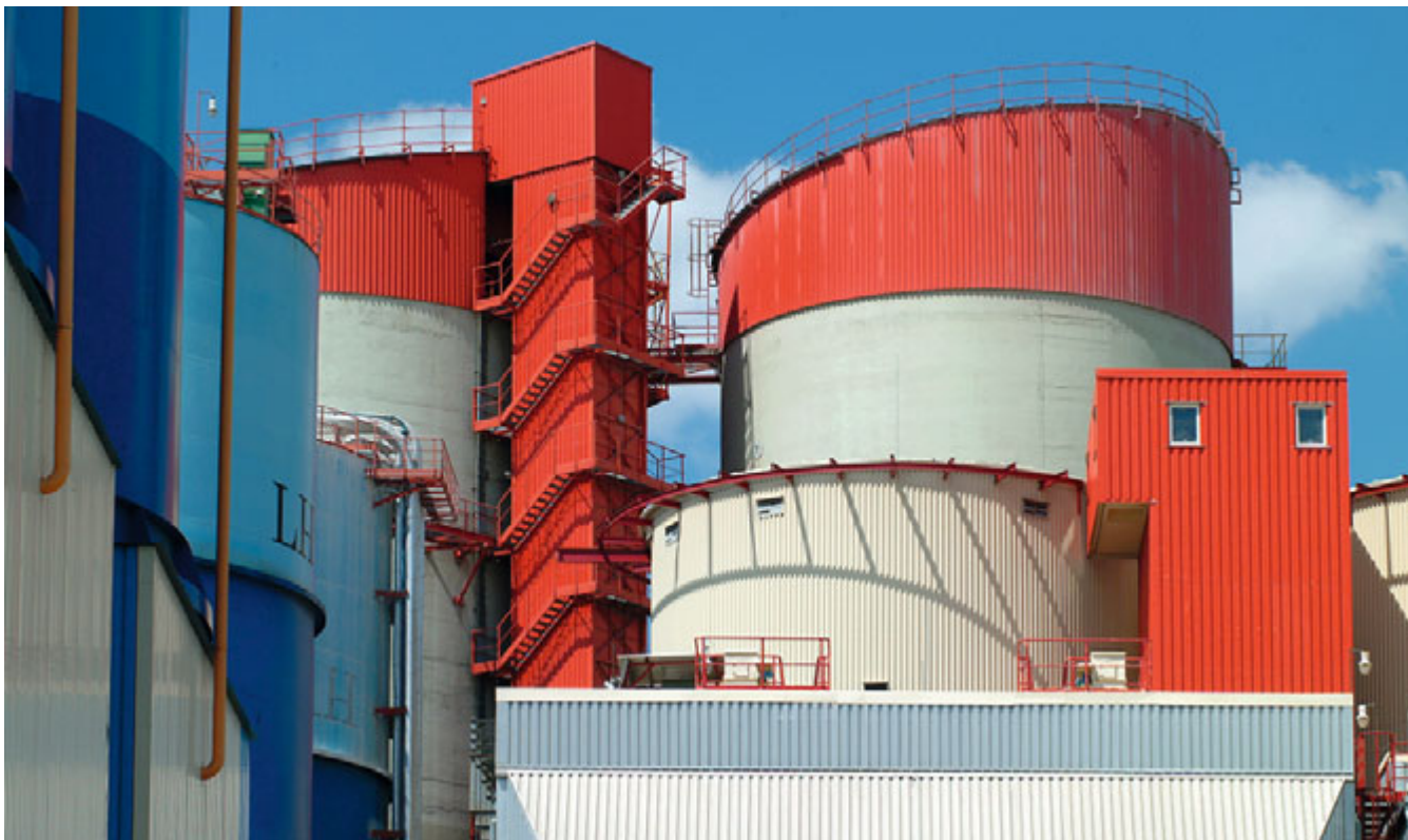
Odsiřovací zařízení v Elektrárně Ledvice
