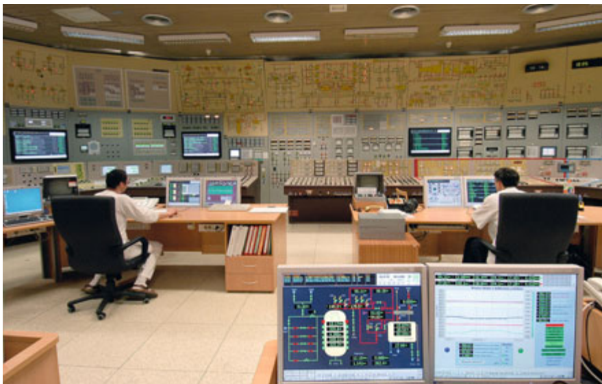
Bloková dozorna Jaderné elektrárny Dukovany
