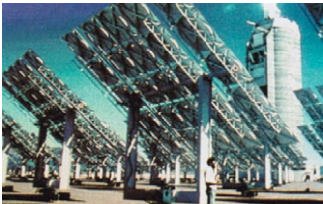
Sluneční tepelná elektrárna
